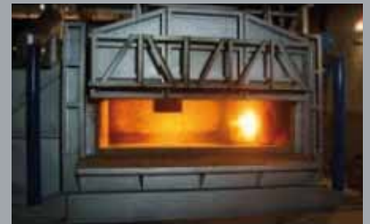
Electric furnace power supply Alimentation de fours électriques
